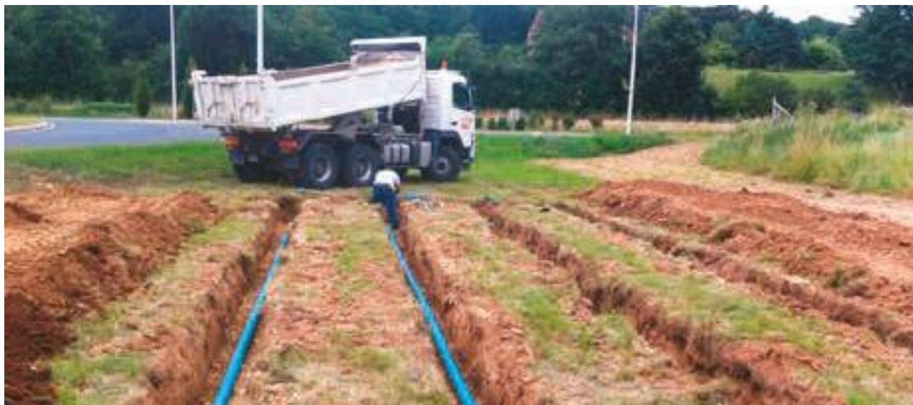
Prétraitement + Traitement des eaux par le sol
