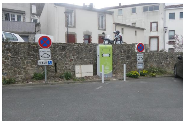
Borne de recharge – Place de Lattre POUZAUGES
